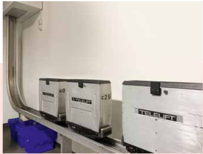
Mit dem Teleafift werden Lieferscheine und kleine Waren durchs ganze Haus transportiert
