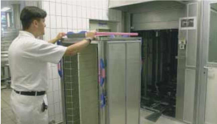
Die Thermowagen, in denen die Speisen auf die Stationen gelangen, werden jetzt zweimal täglich in dieser neuen Waschstraße gereinigt
